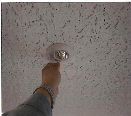
不点灯 非常照明
