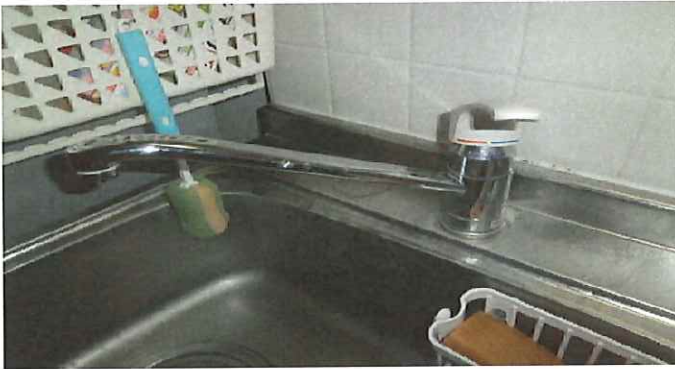
水栓レバー下より漏水
